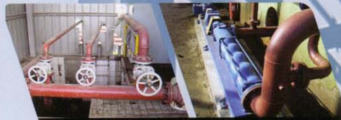
Instalación de Bomba de Cavidad Progressiva (Hidrotermia S.A.)
